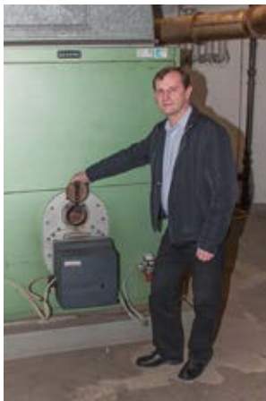
Küster Josef Berger zeigt die 40 Jahre alte und sehr störanfällige Heizungsanlage im Keller der Martinus-Kirche.
